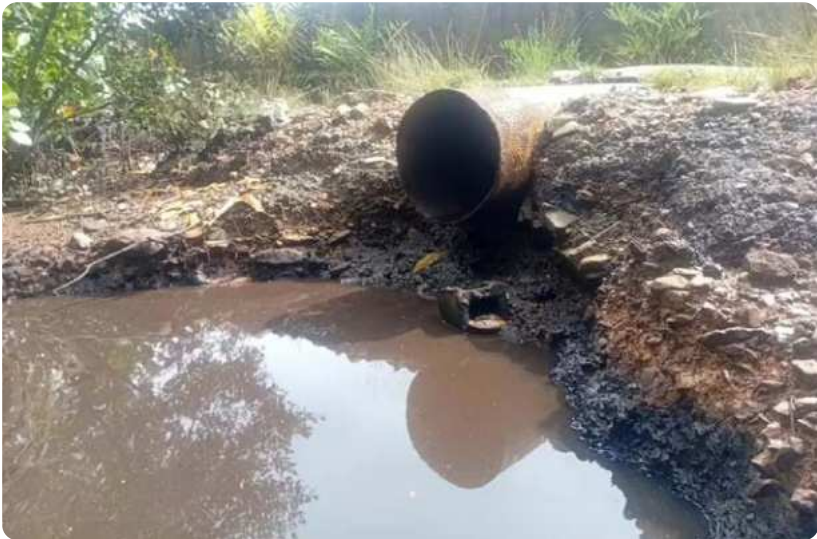
Pipa saluran pembuangan limbah cair PLTU OSS ke badan sungai. Walhi Sultra menguji sampel air dan sedimen dari lokasi pembuangan limbah dan tambak warga ditemukan kandungan logam berat kadmuim dan tembaga melebihi ambang batas baku mutu. (Foto: La Ode Muhlas)
