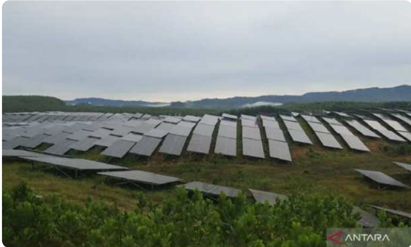
Panel surya di PLTS Nusantara di IKN Selatan. Panel-panel ini menghasilkan listrik 50 MW untuk IKN, sebagai awal masa transisi energi. (ANTARA/novi abdi)
